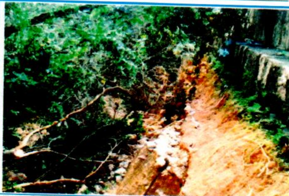
Foto 8 – Fevereiro de 2009. Erosões decorrentes do galgamento do Canal Adutor.
