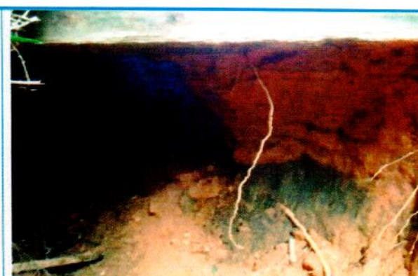
Foto 6 – Maio de 2016. Voçoroca provocada pelas chuvas e erosão.
