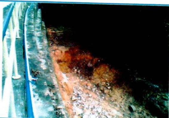
Foto 9 – Abril de 2009. Voçoroca causada pela erosão e pelo galgamento do Canal Adutor.
