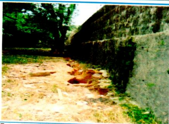
Foto 7 – Fevereiro de 2009. Erosões decorrentes do galgamento do Canal Adutor.
