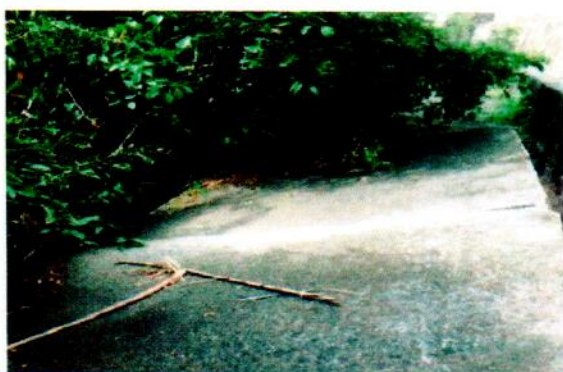
Foto 1 – Setembro de 2015, com início da movimentação das placas de concreto em virtude das chuvas e da erosão.
