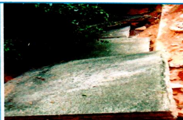
Foto 4 – Maio de 2016. Placas de concreto da calçada que desabaram devido às chuvas e a erosão.
