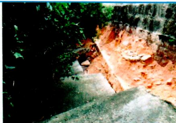
Foto 3 – Maio de 2016. Placas de concreto da calçada que desabaram devido às chuvas e a erosão.
