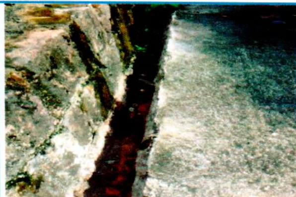
Foto 2 – Setembro de 2015. Deslocamento do concreto da calçada devido às chuvas e a erosão.
