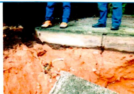
Foto 5 – Maio de 2016. Erosão e placa desabada.
